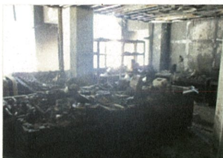
写真 3 火災が発生した実験室(7/2 朝撮影)
