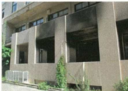
写真 1 火災が発生した実験室の外観 (7/2 朝撮影)
