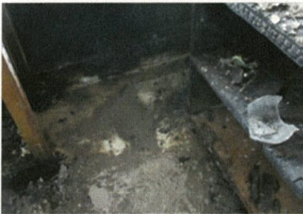
写真 11 火災が発生した実験室 西南角 In-111 回収後(7/2 朝撮影)
