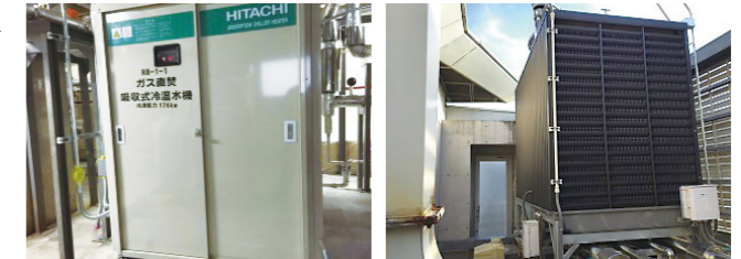
ガス式吸収式冷温水機
