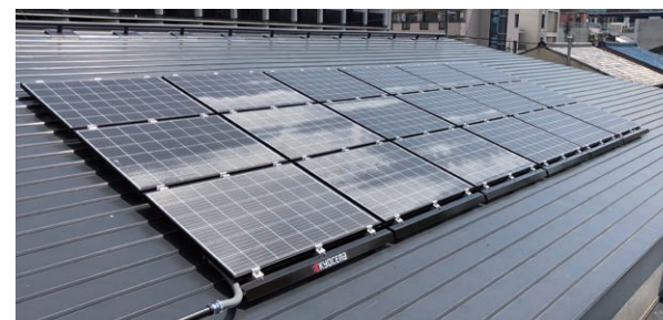
屋上 太陽光発電設備
