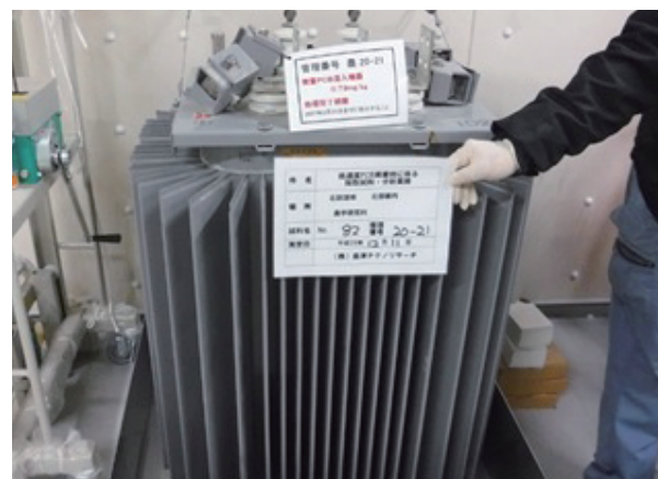
PCB保管状況
