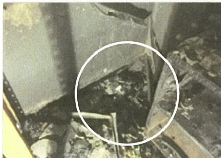
写真 8 火災が発生した実験室 西南側 In-111 があつた場所付近(鎮火直後に撮影)
