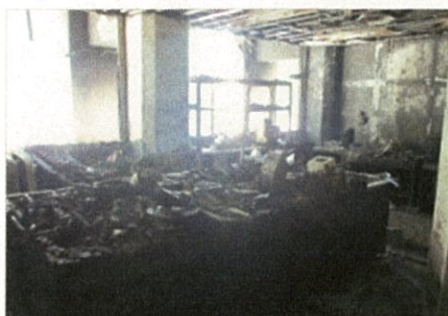
写真 3 火災が発生した実験室(7/2 朝撮影)
