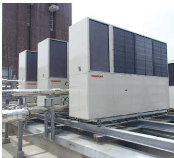
ガスヒートポンプチラー
