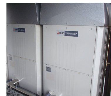
室外機 (平野)研究実験棟
