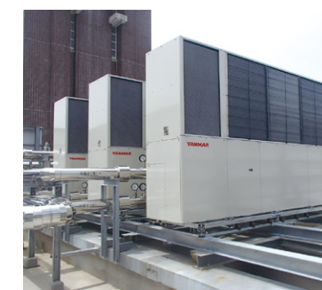
ガスヒートポンプチラー (吉田)百周年時計台記念館
